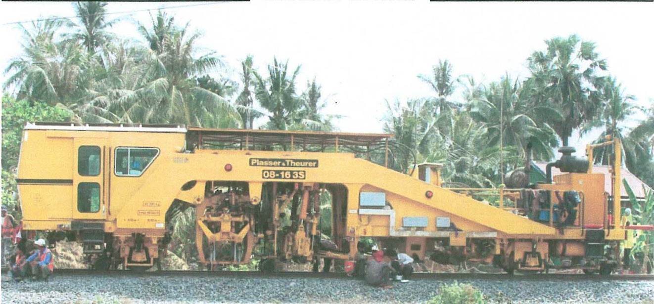
Machine dite « bourreuse ». Elle réalise le dressage des voies, écartement, nivellement et dévers.
