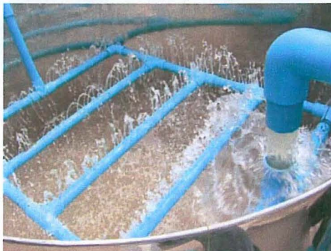
Dispositif d'aération visant à réduire le fer dans l'eau sur une station de traitement
