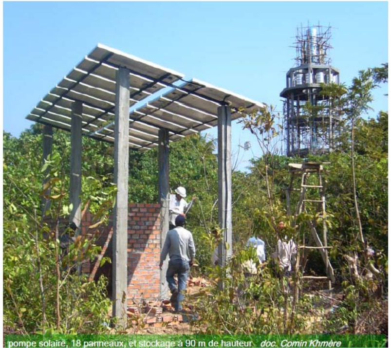
pompe solaire, 18 panneaux, et stockage à 90 m de hauteur. doc. Comin Khmère
