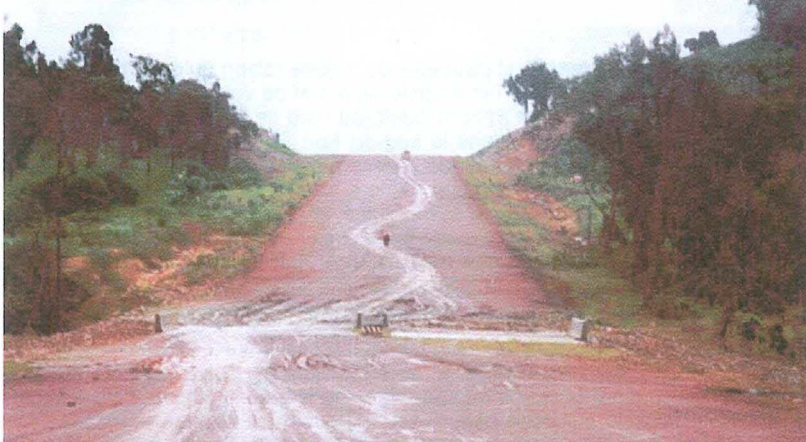
La nouvelle route chinoise n'est pas encore bitumée de sorte qu'elle se dégrade avec chaque saison des pluies.
